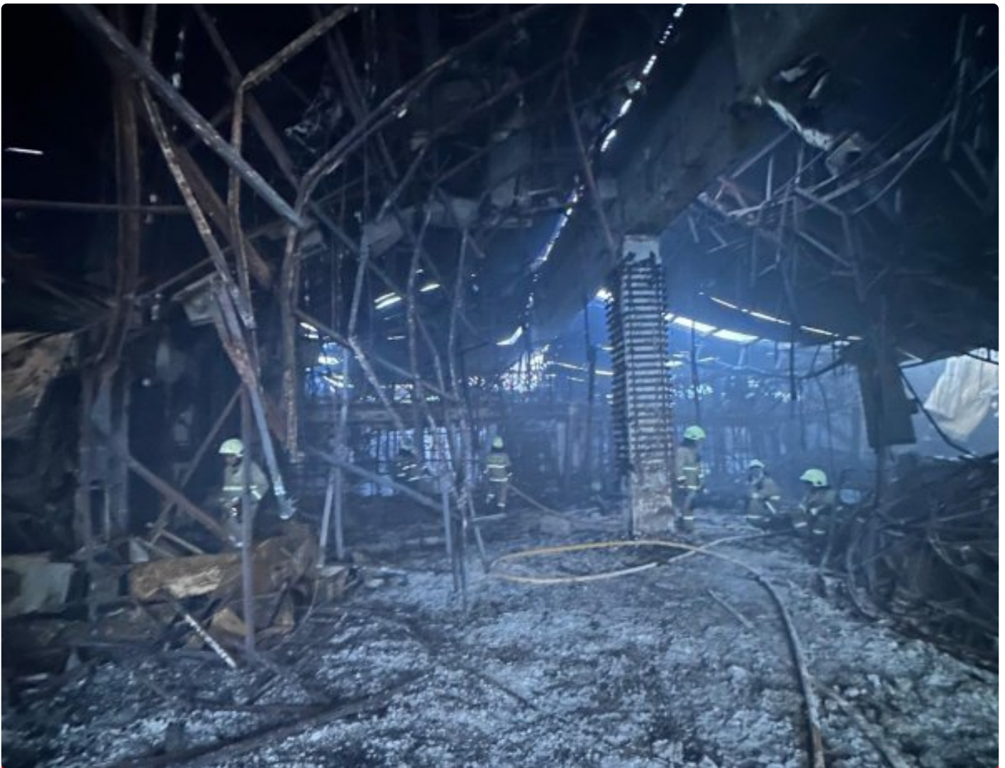
Glodok Plaza yang Hangus Terbakar
